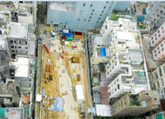
奇靈里兒童遊樂場已經封閉以興建車站出入口，現正進行地基工程。
